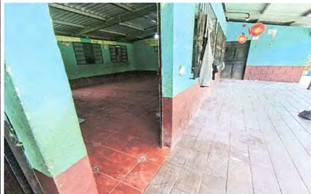
Foto 5: PISO CERÁMICO AULAS Y CORREDOR
